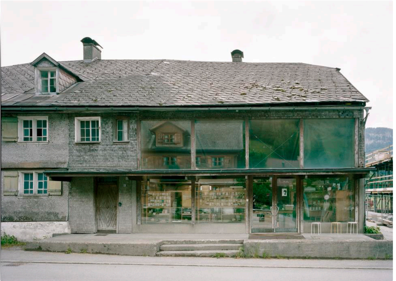
Der Zustand vor der Sanierung. Rechts im Bild die Glasfassade des Umbaus von Leopold Kaufmann
