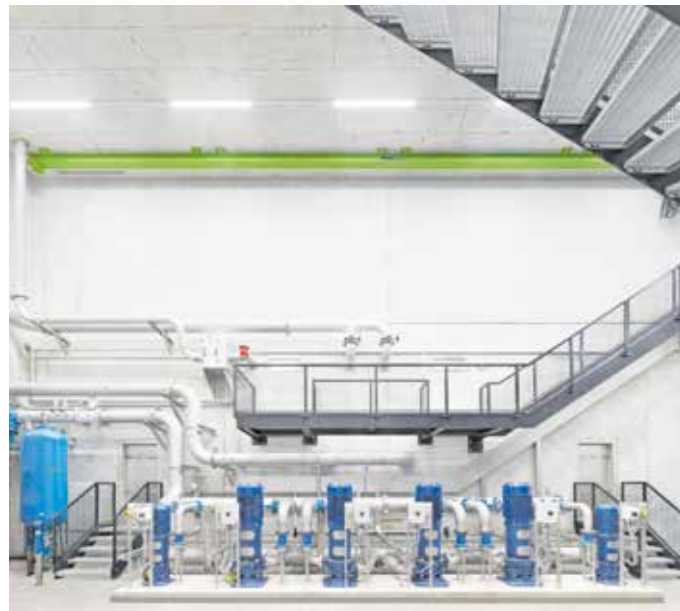
Alle Pumpen zur Versorgung von Hörbranz, sowie teils von Lochau und Hohenweiler sind in der Halle sicher untergebracht.
