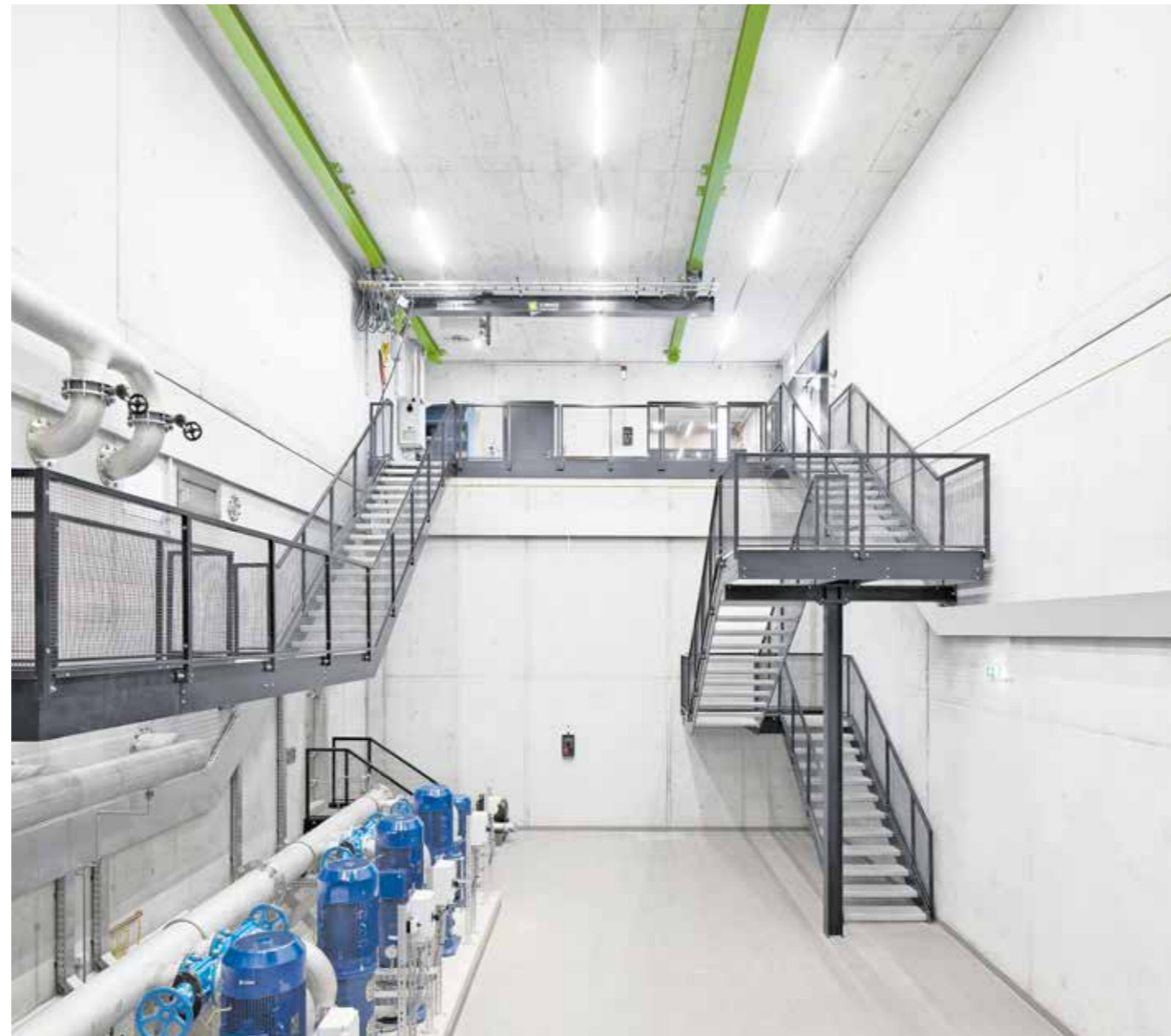
Der Grundwasserbrunnen befindet sich in der hohen Halle aus gedämmten Beton. Sechs Meter unter der Erde docken die zwei Grundwasserbehälter an der südlichen Längswand des Pumpwerks an.
