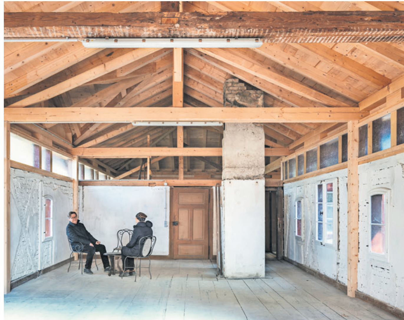
Die Möglichkeit einer Wohnnutzung zeichnet sich in der umgebauten Remise bereits gut ab.
