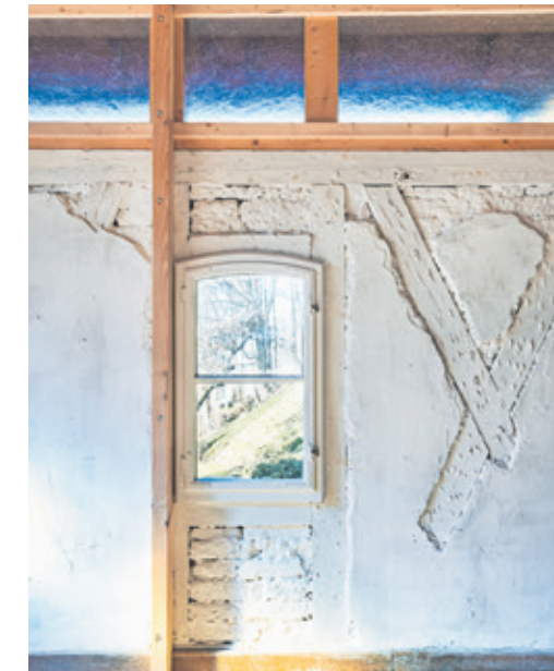
Das Offenlegen der Konstruktion und die Konservierung des Ist-Zustandes der Innenwände prägen die Raumatmosphäre.
