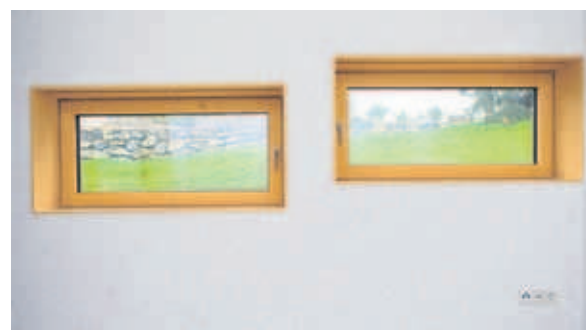
Die unübliche Brüstungshöhe der schmalen Fenster gibt den Zimmern ein neues Raumgefühl.
